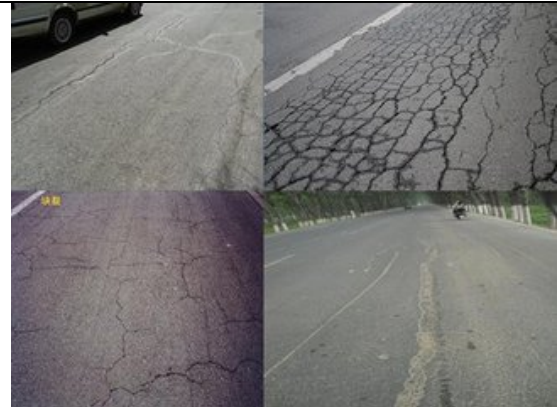
图 3. 沥青路面产生的裂缝
